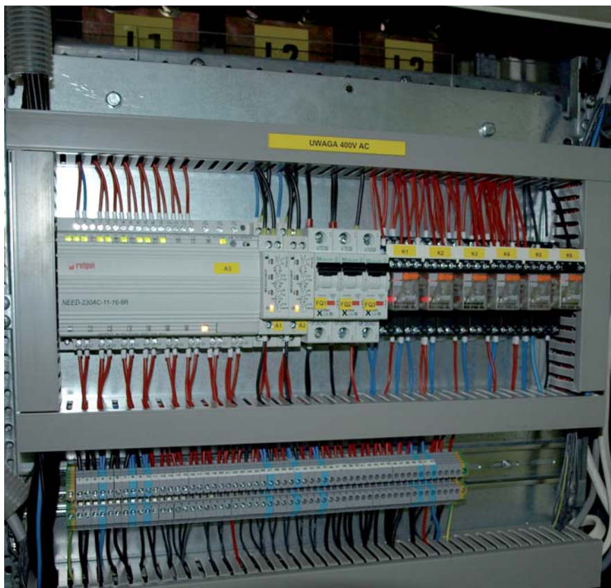
Rys. 1. Stycznikowy moduł automatyki SZR firmy Relpol oparty na sterowniku programowalnym Need
